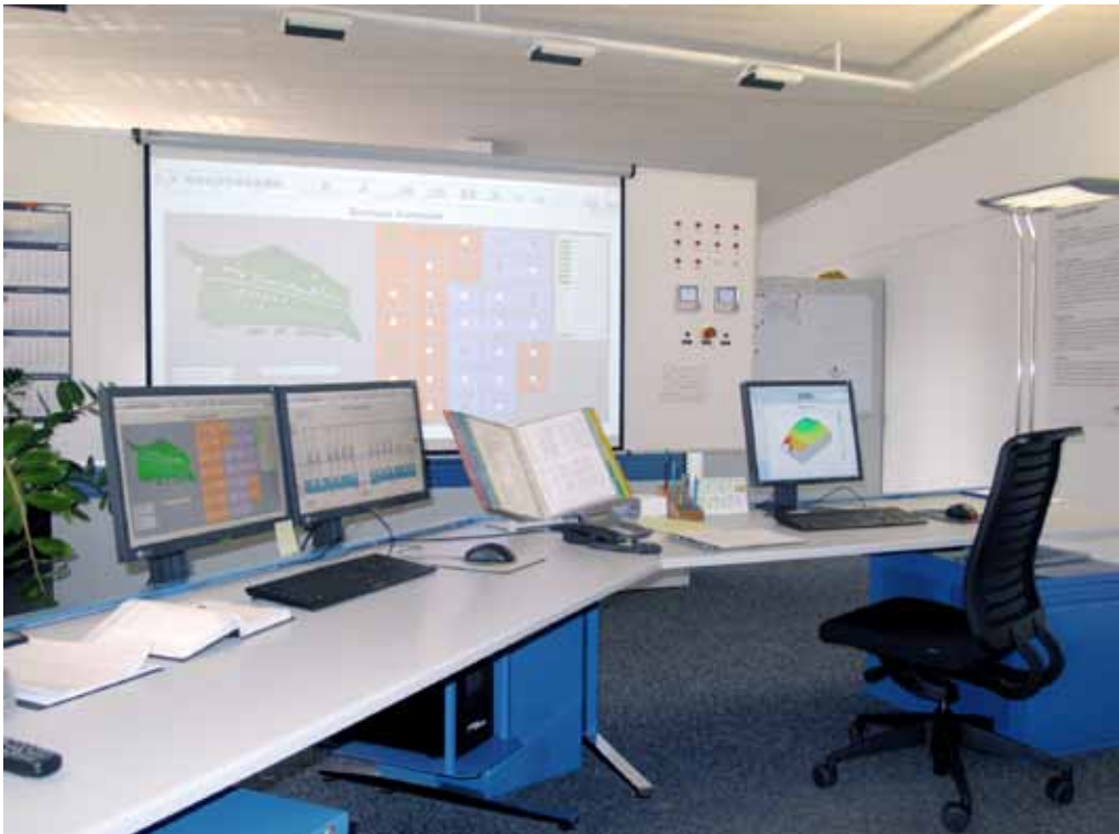
Der Kommandoraum mit dem neu installierten Prozessleitsystem
