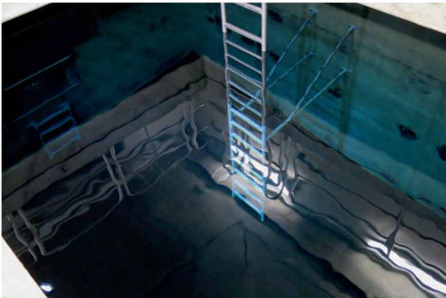
Aktivkohlefilter Hard: Blick auf die Wasseroberfläche einer Filterkammer
