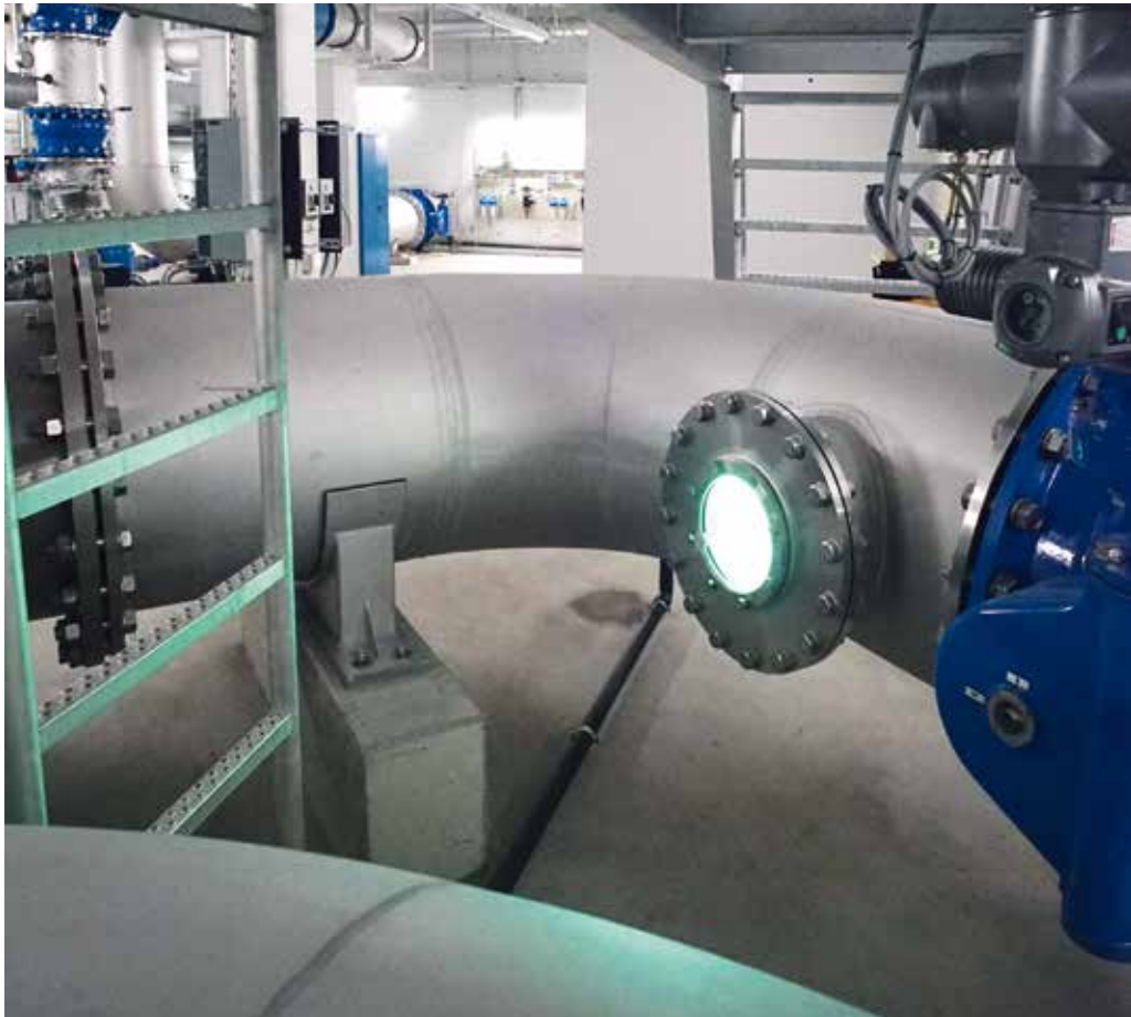
Abgangsleitungen im AKF unmittelbar nach der UV-Desinfektion
