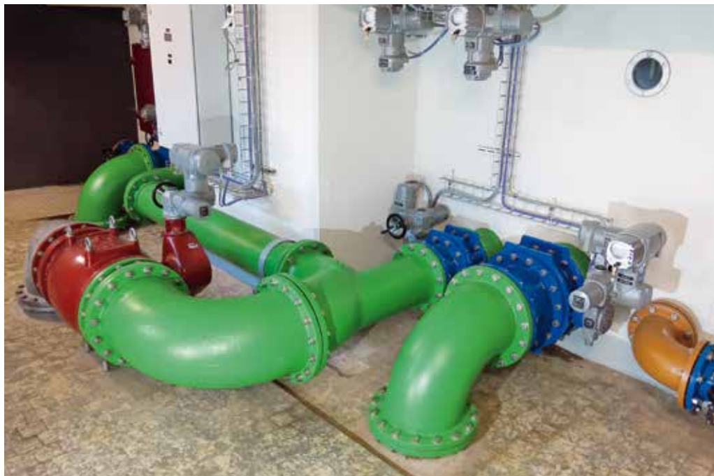
Der Rohrleitungskeller des Schnellfilters 1 mit neuen Armaturen und Elektroantrieben
