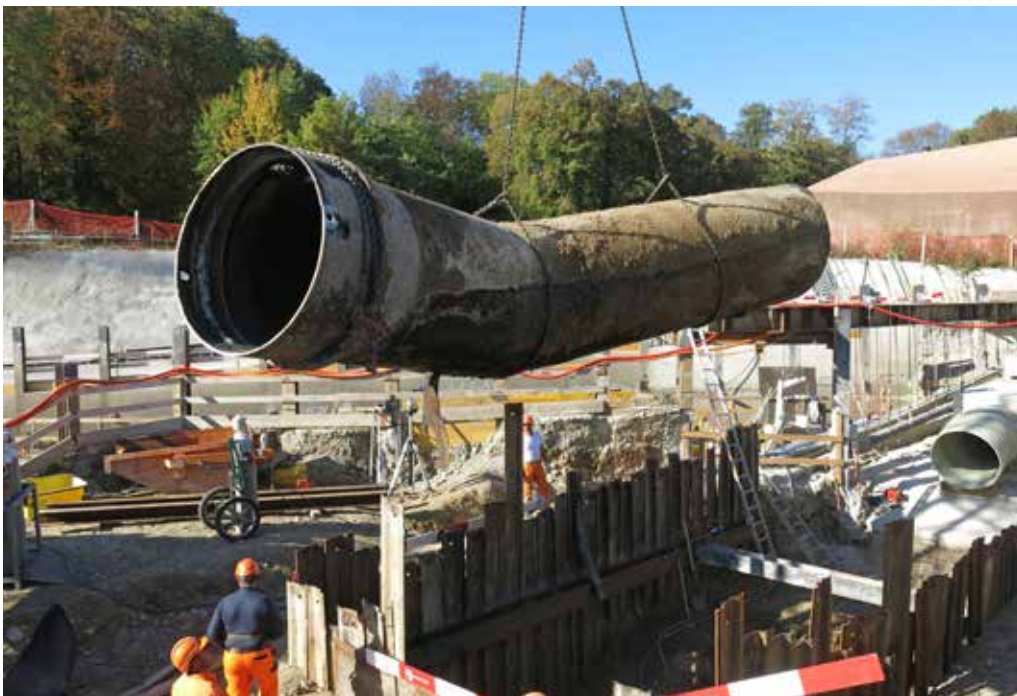
Ein nicht mehr benötigtes Stahlstück wurde abgetrennt und anschliessend aus der Baugrube entfernt.
