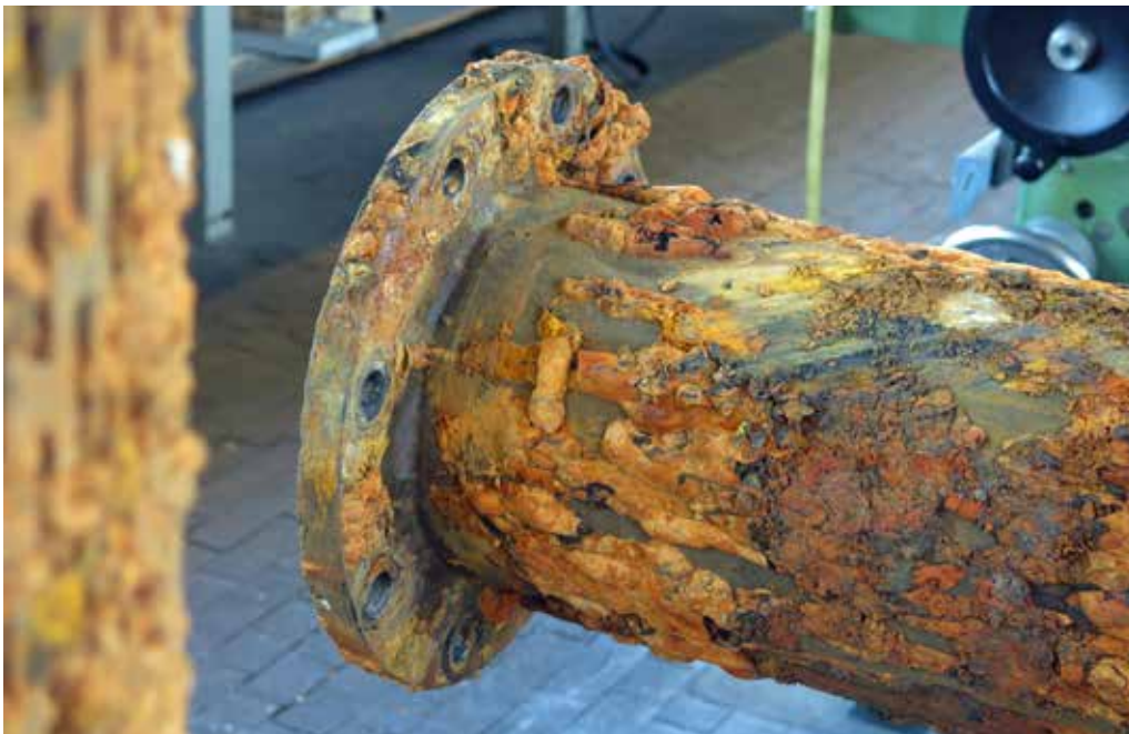
Korrosionsangriff auf einem Brunnenflanschrohr nach jahrzehntelanger Betriebsdauer
