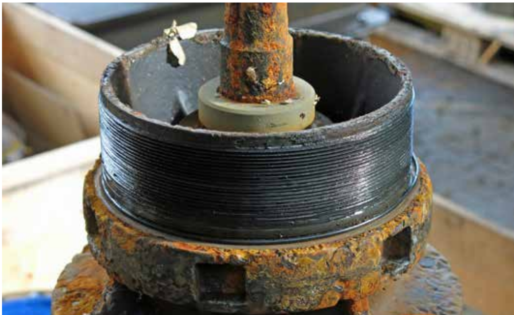
Auch Pumpenwelle und Sternlager zeigen einen Korrosionsangriff und haben eine Aufarbeitung nötig.
