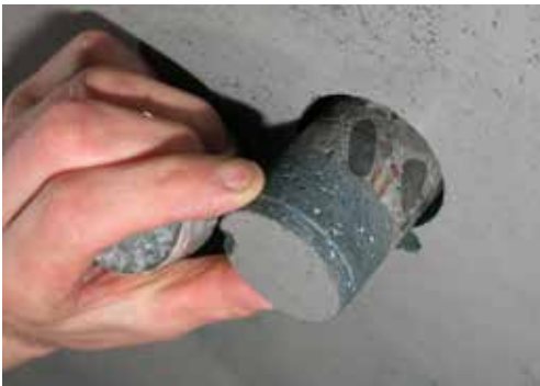
Bohrkernproben zeigen die fein strukturierte, ca. 2 cm starke Mörtelschicht auf dem Betonuntergrund.
