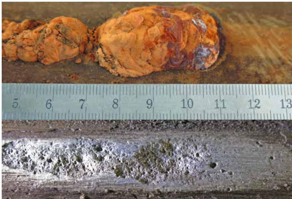
Korrosionsangriff unter der Lupe: unten ist der Materialabtrag an der genau gleichen, gereinigten Stelle deutlich sichtbar.
