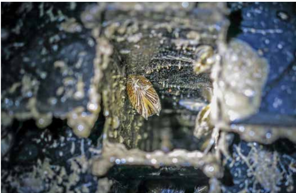
Quagga-Muscheln haben sich in den Wabenelementen des Absetzbeckens A02 eingemischt.
