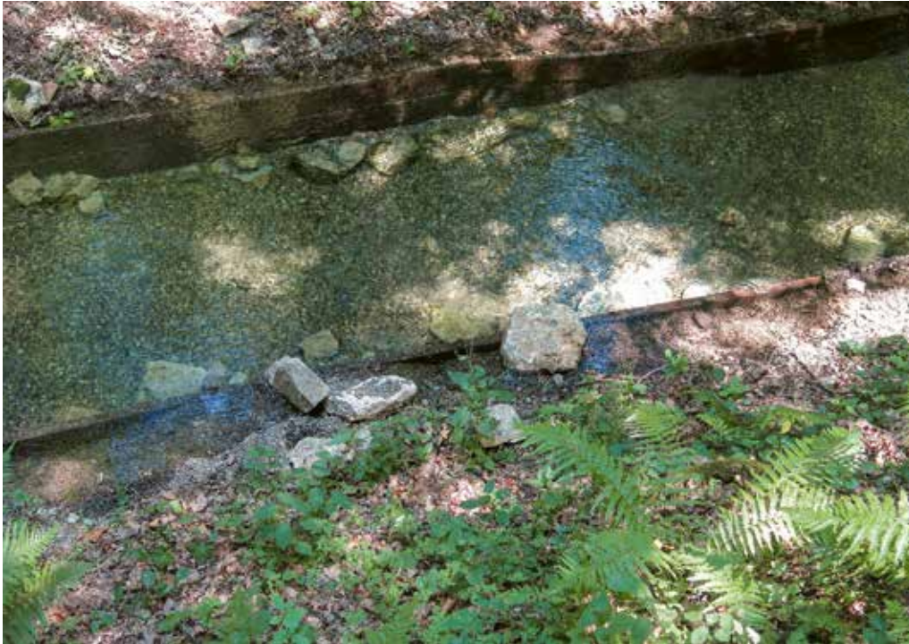
Wildschweine haben den Weg in die Hard gefunden und beschädigen auf ihrer Futtersuche die Grabenverbauungen.
