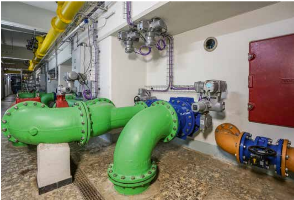
...und warten auf die erste Inbetriebnahme.
